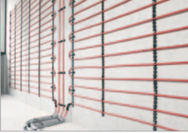
Şekil 4-15 Islak yapı tarzında REHAU duvardan ısıtma/serinletme
